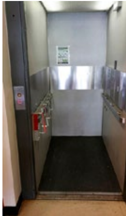
Plateforme élévatrice pour accéder au cinéma
